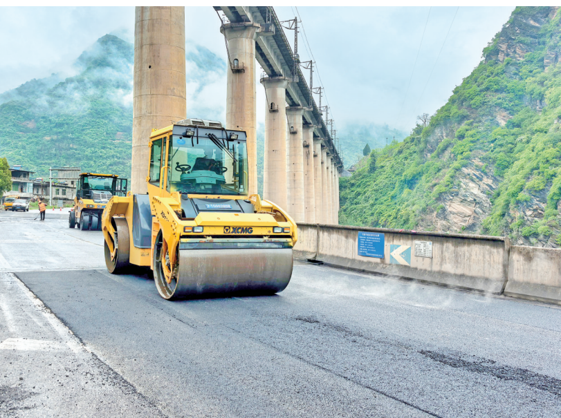
4月12日，安康市公路局旬阳公路段开展路面病害专项整治养护作业，对路面破损、沉陷等病害沥青面层进行精细化铣刨处置，高效完成病害修复处置13处，共计2100平方米。
