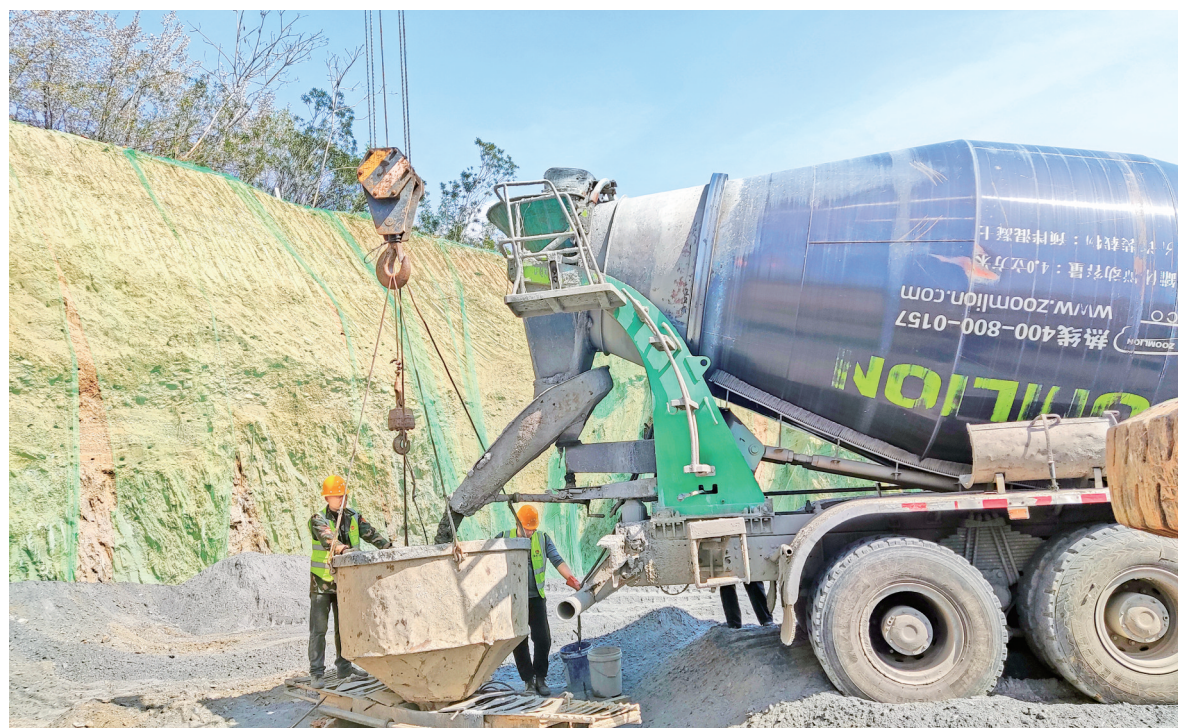
3月29日,安康新关店汉江大桥启动主桥16号桥墩的第七根桩基混凝土灌注,目前已完成9根桩基施工。钱元立 张旭 摄
