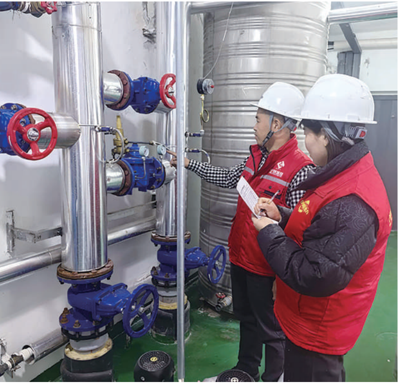
宁陕县住建局近日协调热力企业开展供热安全专项检查,确保供热安全、稳定、高效。图为11月28日,宁陕城投热力公司工作人员在一处分散式清洁能源供热站内对供热设施进行检查。
