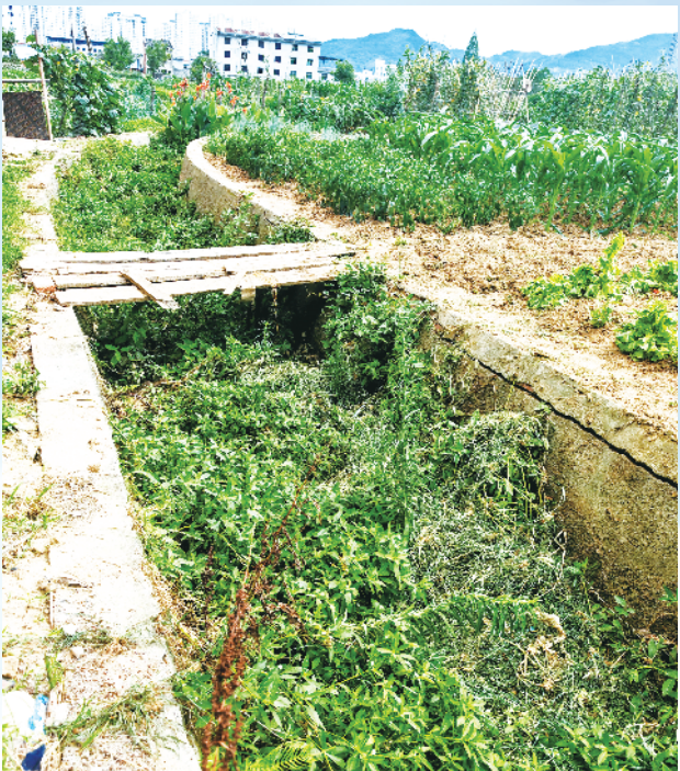
荒废的新二挡渠
