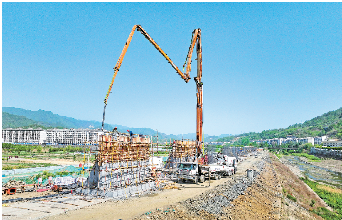
在汉江石泉县城关镇杨柳防护区(右岸)综合治理项目建设现场,施工人员在抢抓黄金施工工期进行防护河堤浇筑作业,在安全生产前提下推动项目提速完工。据悉,该项目总投资1.386亿元,包含堤防、下河路步等防护工程,建成后有效改善县城严峻的防洪形势,推动县域经济高质量发展。
