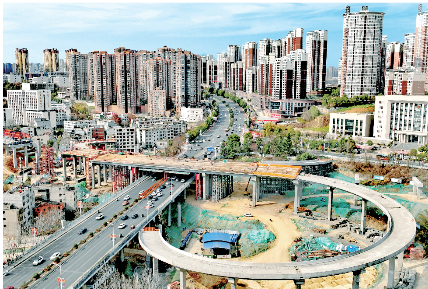
七里沟立交是安康中心城区第一座全互通首跨式市政立交，该立交位于西津汉江大桥北头，路线总长1200米，设计标准路幅宽度40米，双向六车道。该项目建成后，将对解决高新、江北、黄沟及江南等片区交通转换、打通长泰路、填补城区路网空白、提升中心城市形象有着重大意义。因为正在施工中的七里沟立交。 王闰 摄
