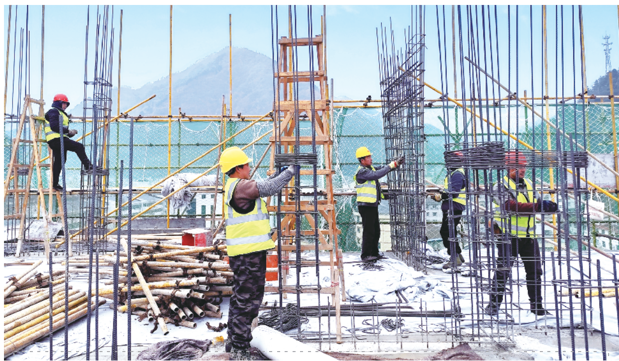
1月4日,在宁陕县城关镇城投幸福里建设项目施工现场,工人们奋战在各自岗位上。该项目对提升县城综合承载能力、改善居民住房条件、塑造宁陕城市新形象以及推动旅游产业发展具有重要意义。 王辉 摄
