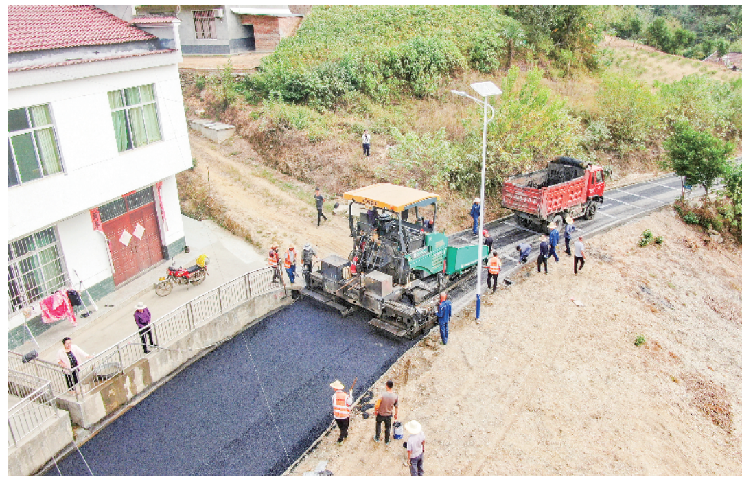
今年以来,平利县西河镇深化拓展“三个年”活动,在建工程项目建设提速增效。图为西河镇茶业现代农业园区道路拓宽改造项目施工现场。梅兴宇 摄
