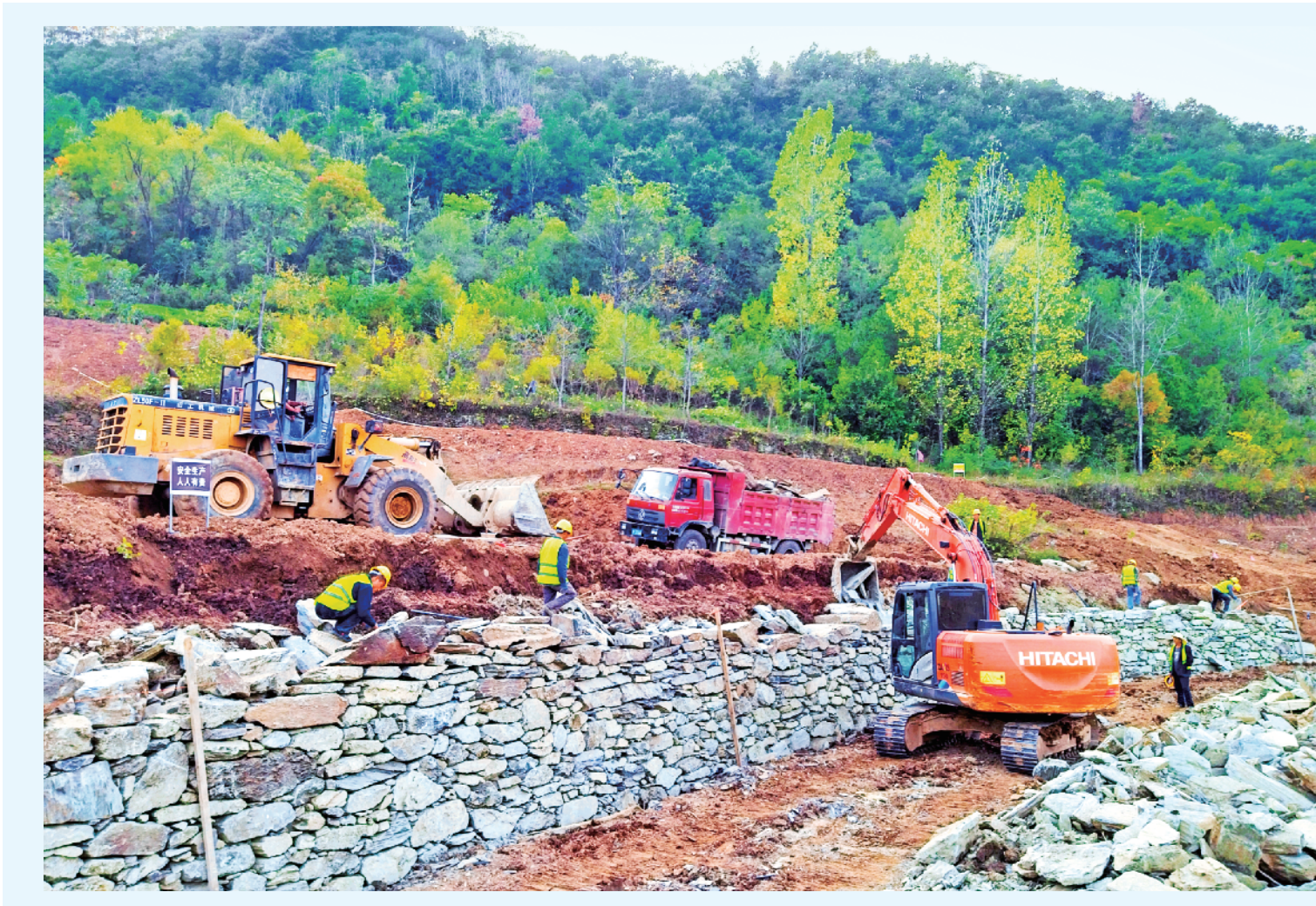
连日来,旬阳市双河镇抢抓黄金施工期,高效有序推进高标准农田项目建设。图为10月27日,该镇高坪社区129亩高标准农田建设现场的繁忙景象。潘文进 摄
