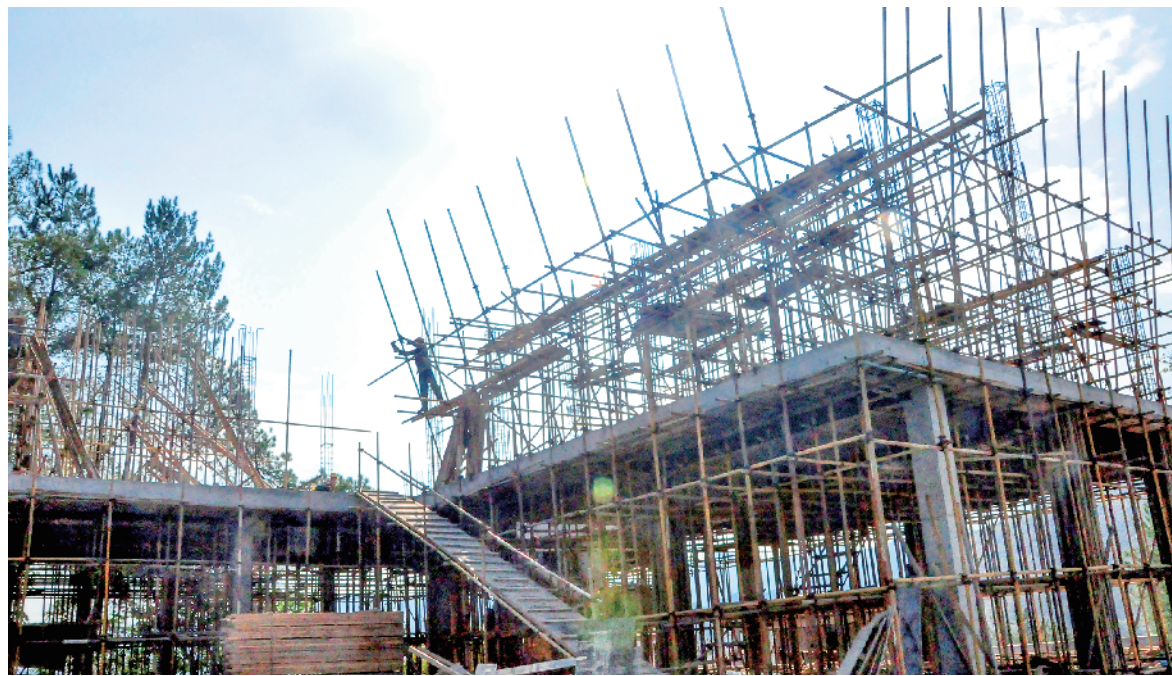
日前，工程人员正在紫阳县向阳魔芋包茶厂改扩建项目现场施工。该项目是紫阳县2024年确定的重点项目之一，项目建成后，将满足紫阳县富硒茶生产、加工、销售和紫阳县富硒茶开发研究、游客观光、制茶、品茶、休闲等需要。 彭召伍 摄
