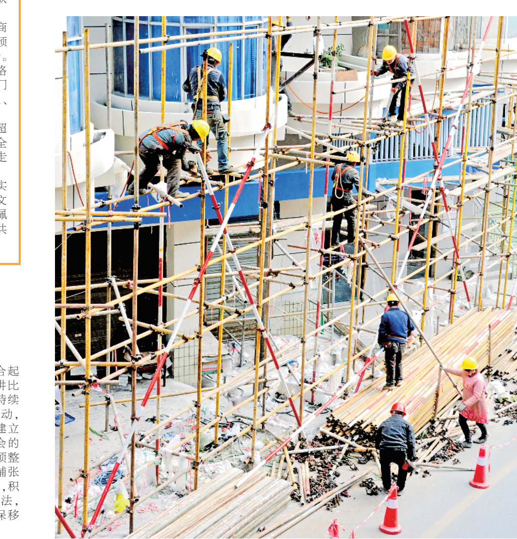
2022年10月以来，紫阳县住建局把老旧小区改造作为改善民生的重要抓手，纳入改造规划内的100多栋楼已改造60%以上，预计2023年4月全面竣工。图为1月8日红江路改造现场。彭伍伍摄
