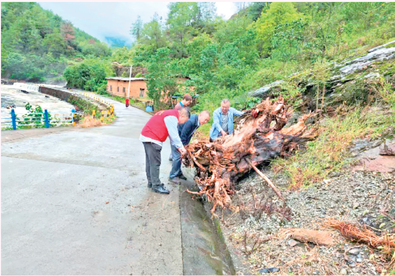
近日,连续降雨造成汉滨区沈坝镇辖区内存村组道路主干线多处发生山体滑坡,阻塞道路。9月19日,该镇组织各村(社区)“四支力量”,积极做好道路沿线排除险障工作,确保村民出行安全。
