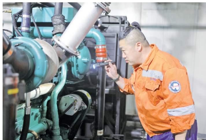
发电班班长张冬在对发电机进行巡视检查(12月1日报)。新华社记者 黄韬铭 摄
