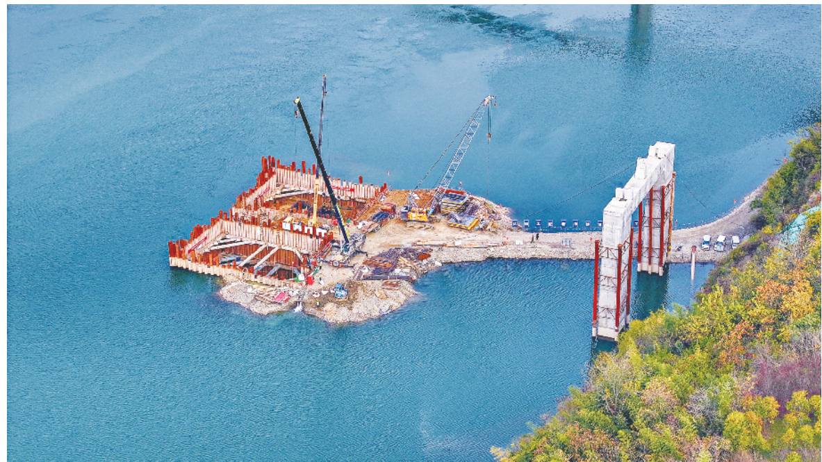
12月4日,安康新关庙汉江大桥最大跨度180米的主桥墩完成第一层混凝土浇筑,大桥主桥墩施工进入冲刺阶段。 皮勇维 摄
