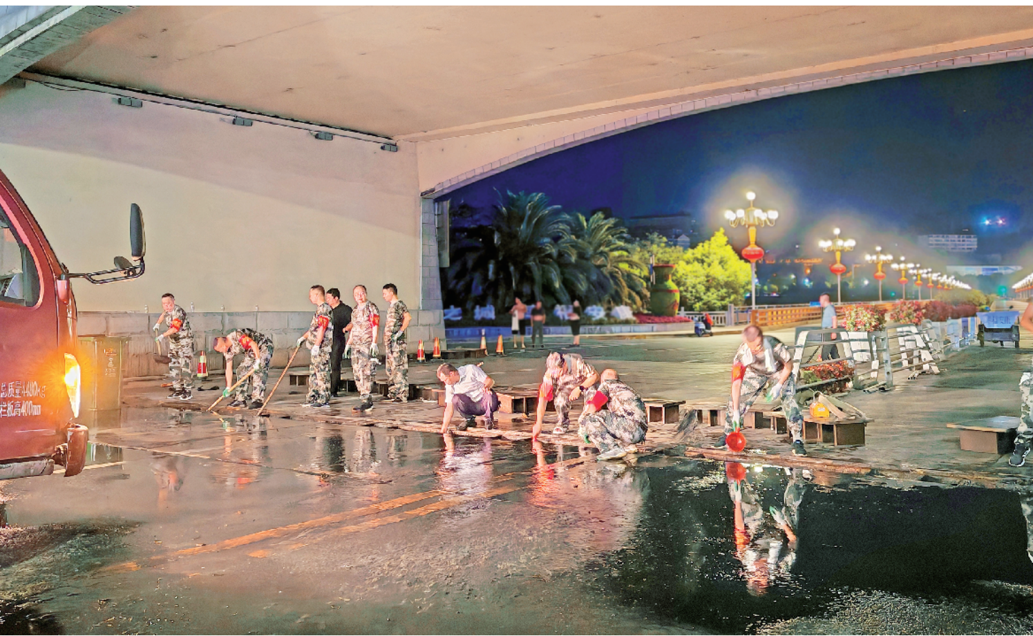
「月」日凌晨一时，汉滨区水利、防汛、市政、交警、河道堤防管理处、安康宏远建设（集团）有限公司护坝队等单位，在安康城区开展了防汛应急演练活动。活动从开始到结束，历时约1小时30分钟，完成了交通疏导、闸槽清理、闸门吊架、安装调试、检修维护等闭环程序。本次演练圆满完成了检修、维护、衔接配合等预定目标，全面检验了《安康城区防汛预案》的科学性。
