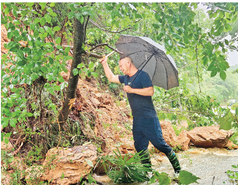
▲石泉县连续强降雨而造成部分道路塌方,全县基层党员干部积极投身防汛救灾一线。图为城关镇枫树村驻村干部冒雨进行道路疏通。
