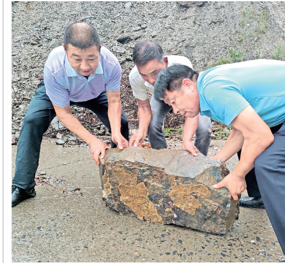
汉滨区早阳镇广大党员干部闻“汛”而动,立即深入防汛一线,扎实开展排查巡查、转移安置群众,用责任和担当守护广大群众生命财产安全。图为7月9日,早阳镇兴胜村党员干部在巡查中清理公路上的塌方。
