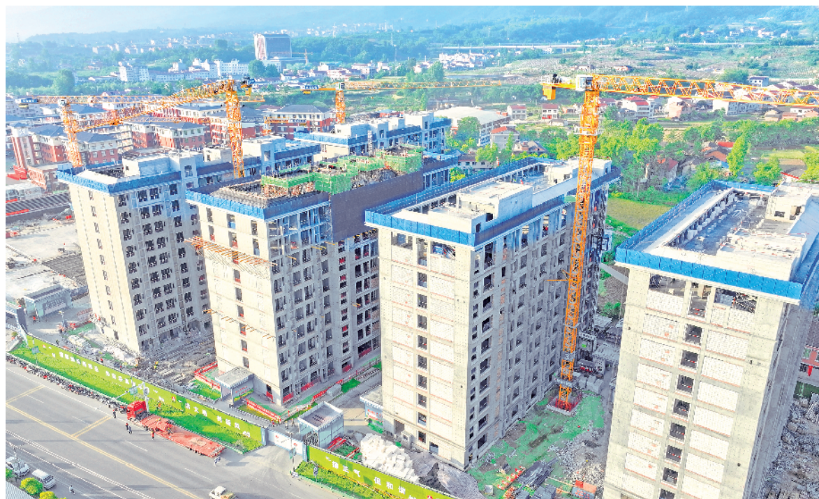
日前,在汉阴县实验中学建设二期工程项目施工现场,工人正忙着内部的水电安装和墙体粉刷工作,目前该项目的主体已经完工。建成投用后,可解决汉阴县实验中学和汉阴县第二高级中学缺少教师宿舍及运动场的问题,可满足5000余名学生的全寄宿需求。
