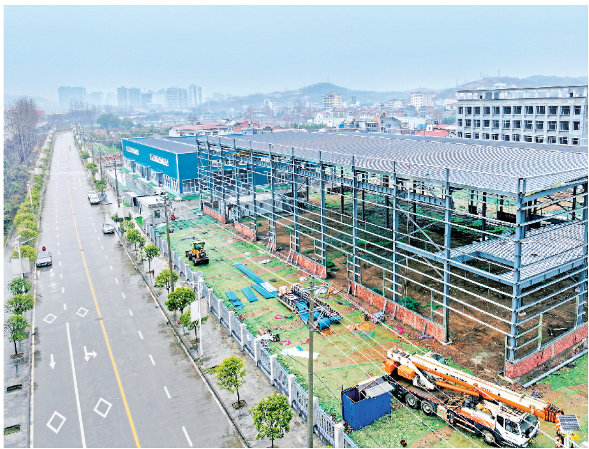
经过几个月的紧张建设，1月16日，汉阴县金坤实业有限公司3500平方米的碳素科技研发中心项目，一号楼和二号仓库主体施工已完成，一号楼内部装修和外立面装饰工作已完成40%，二号仓库已经投入使用，三号仓库加工中心钢结构主体已经完成。该项目建成后，将推动汉阴县碳素新材料产业链不断发展和延伸，提高碳素新材料产业链科技水平，为打造全国碳基材料新高地打下坚实基础。
