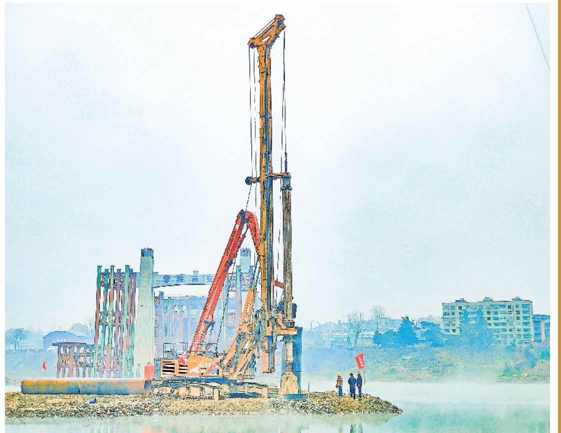
笔者近日在汉滨区新关庙汉江大桥施工现场看到,工人们正在抢抓冬季枯水期,全面推进汉江南岸14号墩筑岛围堰工作。据了解,新关庙汉江特大桥是我市“十四五”重大基础设施建设项目,也是2023年民生实事票决项目之一。全长782米,桥梁宽度43.5米,其中北引桥长352米。目前,桩基全部完成,墩台完成33个,北引桥箱梁主体贯通。
