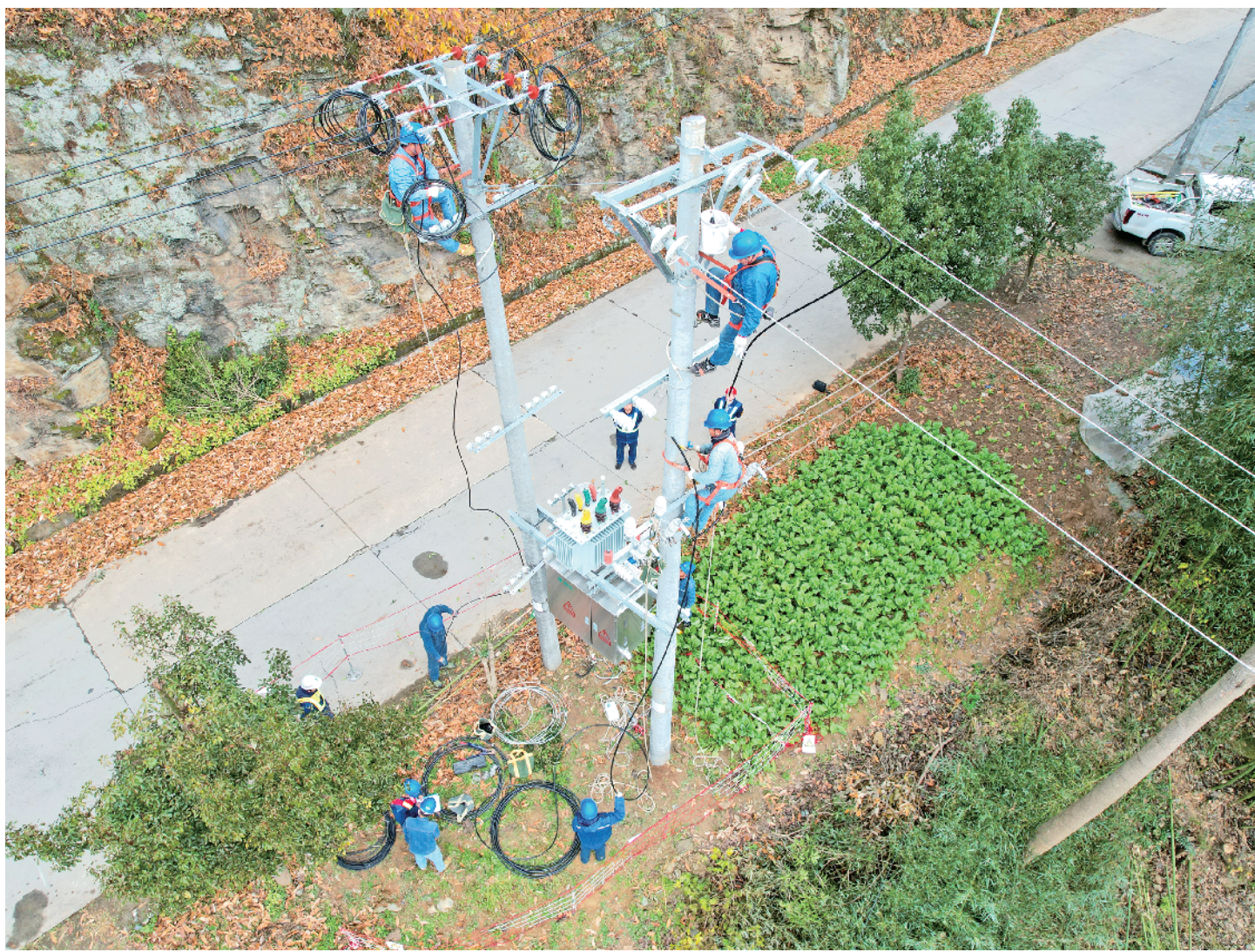
入冬以来,随着气温下降,用电负荷不断攀升。对此,国网汉阴县供电公司不断加大农网改造、变电站巡查、线路检修力度,对存在的隐患及时清理排除,确保电网运行安全和居民可靠用电。图为12月12日,国网汉阴县供电公司工作人员正在对麻柳线栋梁村2号公变实施低电压改造。刘东 摄
