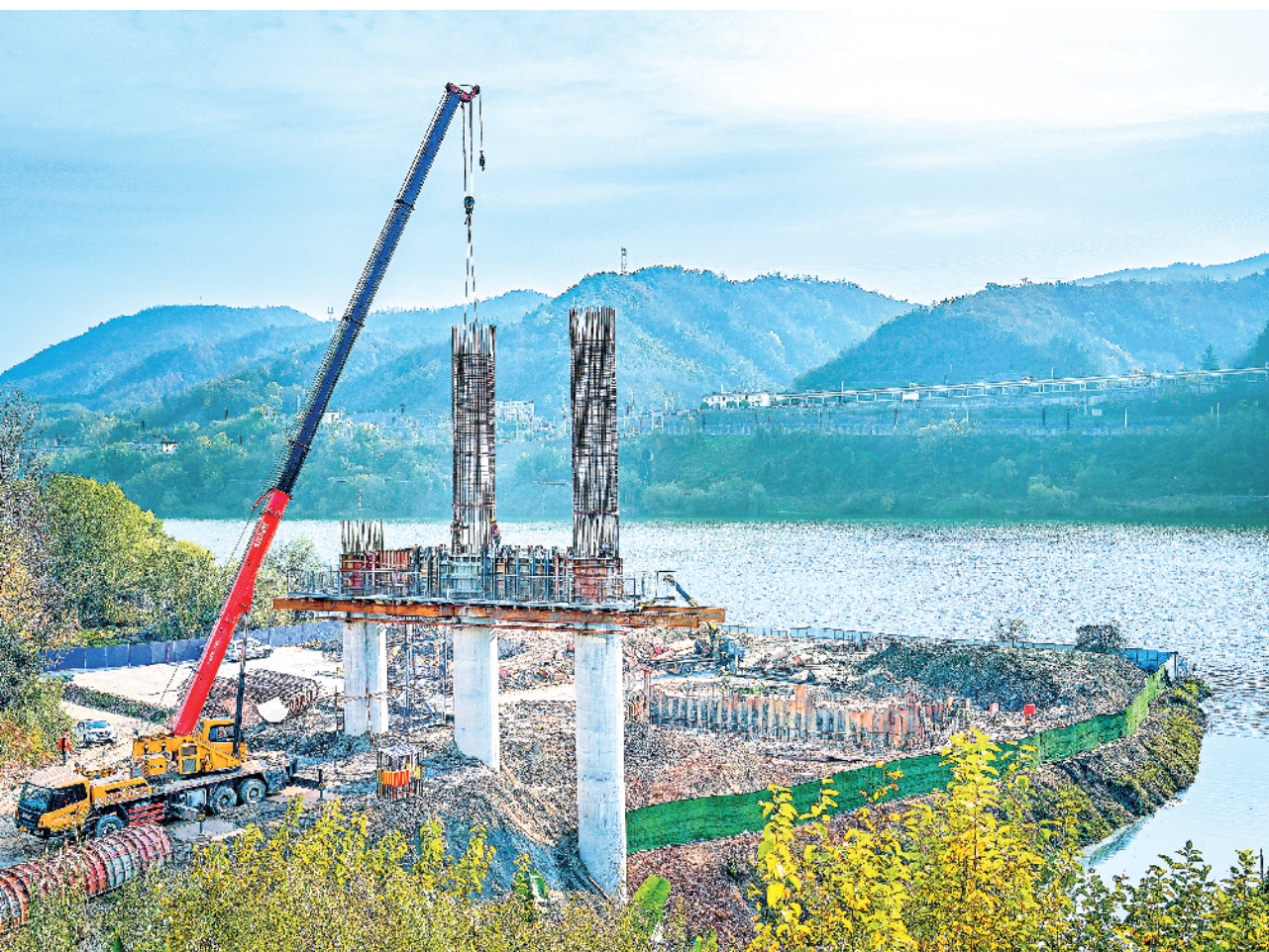
在石泉县汉江四桥项目施工现场，工人们正在进行运输、吊装、焊接等各项作业，施工现场井然有序。据悉，该桥梁全长1222.19米，为石泉县城第四座汉江大桥，建成后将对辖区经济和交通发展具有重要影响。
