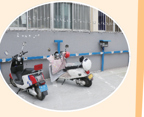
改造后的老旧小区增添了充电桩，为居民提供了方便
