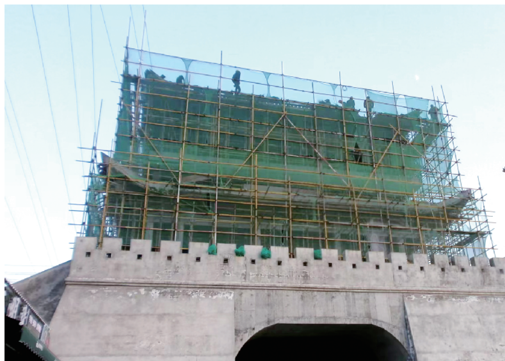
11月20日,安康中心城区西坝防洪堤施工现场,工人们正利用晴好天气抓紧施工。作为民生工程,该项目完工后将为中心城区增添一道靓丽景观。李向军 摄
