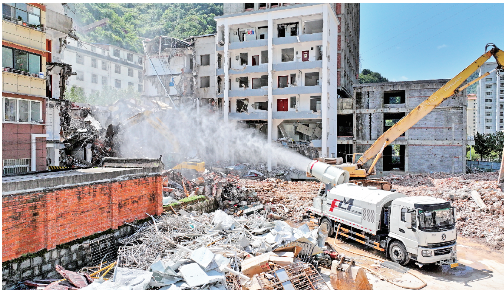
今年以来,宁陕县学习借鉴浙江“千万工程”经验,因地制宜,统筹推进以“三拆三建三提升”为主要内容的县城人居环境整治百日攻坚行动,为建设“三宜”县城奠定基础。目前,全县累计拆除围墙19处753米、违建房屋3147平方米、违建广告162处,建设乡村绿道1.4公里,新建停车位300个。图为工作人员对危旧房屋进行拆除。王辉摄
