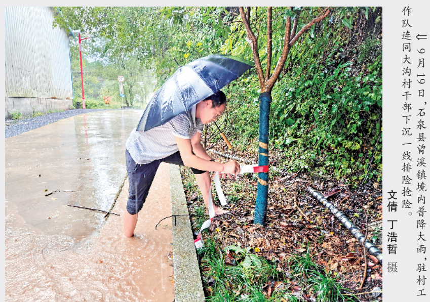
←6月10日,石泉县曾溪镇境内普降大雨,驻村工作队会同大沟村干部下沉一线排险抢险。文倩 丁浩 摄
