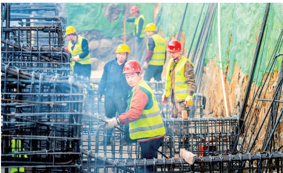
宁陕县城市供水管网更新工程项目现场,工人们正抢抓工期赶进度。
