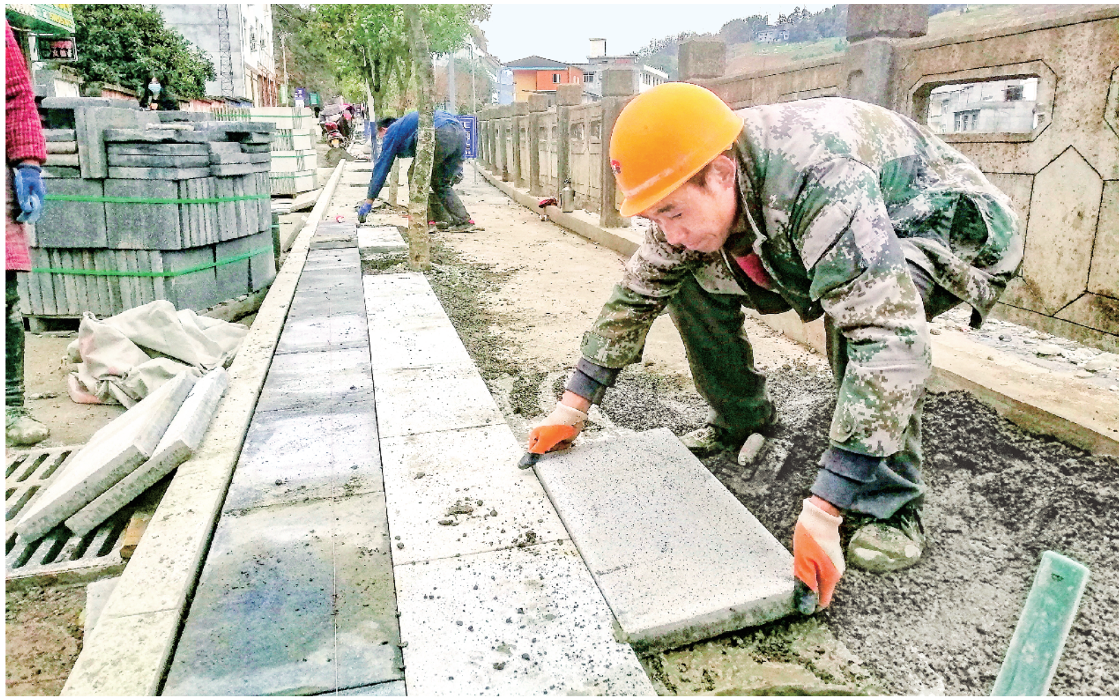
总投资2000万元的岚皋县石门镇集镇配套设施提升建设工程于去年2月动工，该项目在改建道路、雨污分流管网的同时，实施消防、照明、绿化等附属工程，整个工程将于今年5月1日竣工投入使用。 张天兵 摄
