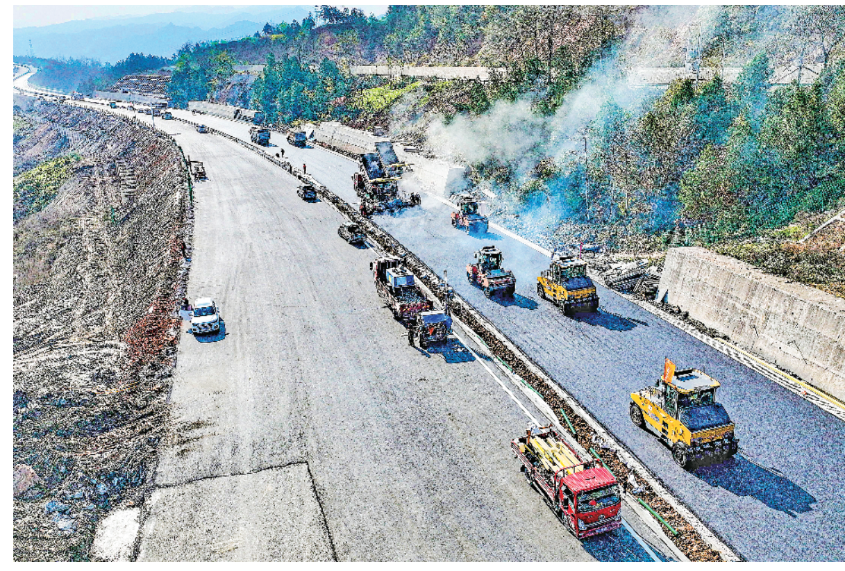
11月25日，宁石高速公路建设工作已进入收尾阶段，在宁石高速古坝社区特大桥施工现场，项目建设单位正组织大型工程机械铺设最后一段沥青路面，预计12月5日建成通车。董长松 摄
