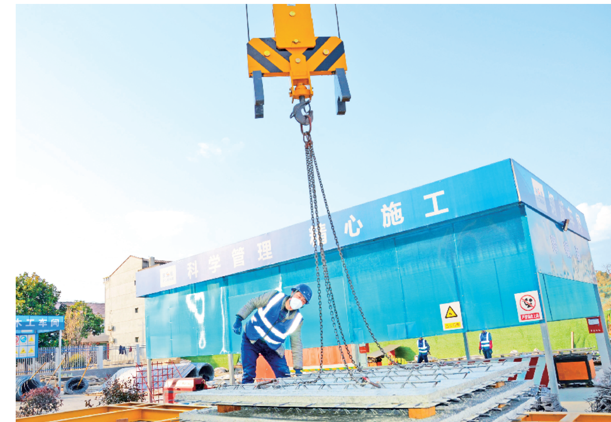
近日，陕建十二建集团新型建材产业园职工宿舍项目顺利实现主体封顶，主体二层及以上结构由预制墙板、叠合楼板、预制楼梯等混凝土预制构件组成，构件在施工现场安装后，与现浇墙体钢筋绑扎连接以及楼面梁、板叠合现浇形成整体。该项目装配率达65.93%，是安康首个采用竖向预制构件的项目，也是安康第一个A级装配式建筑。图为工人正在进行预制构件叠合板吊装。 刘煜晨 摄
