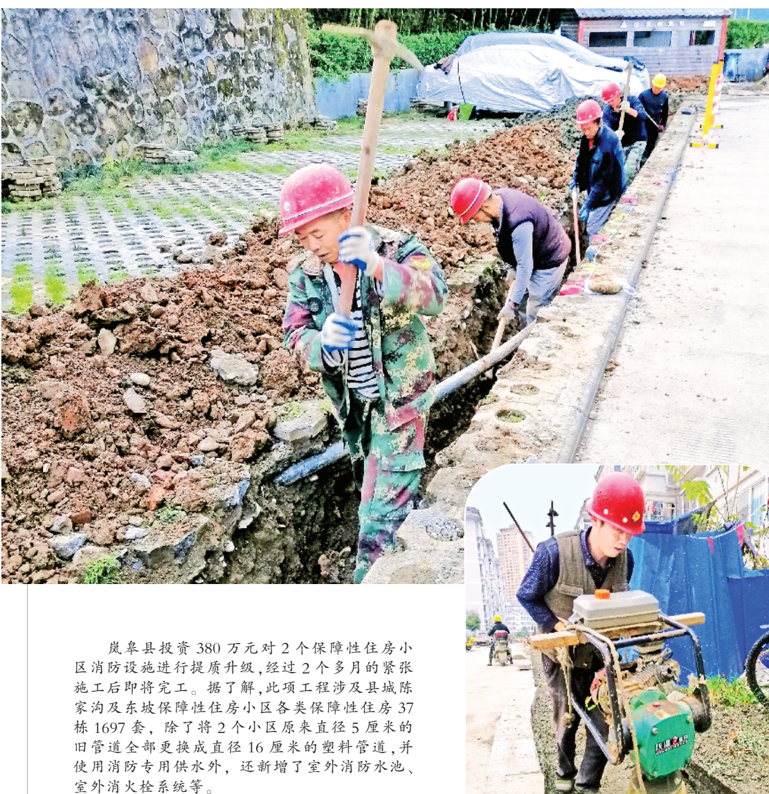
岚皋县投资380万元对2个保障性住房小区消防设施进行提质升级,经过2个多月的紧张施工后即将完工。据了解,此项工程涉及县城陈家沟及东坡保障性住房小区各类保障性住房37栋1697套,除了将2个小区原来直径5厘米的旧管道全部换成直径16厘米的塑料管道,并使用消防专用供水外,还新增了室外消防水池、室外消防栓系统等。
