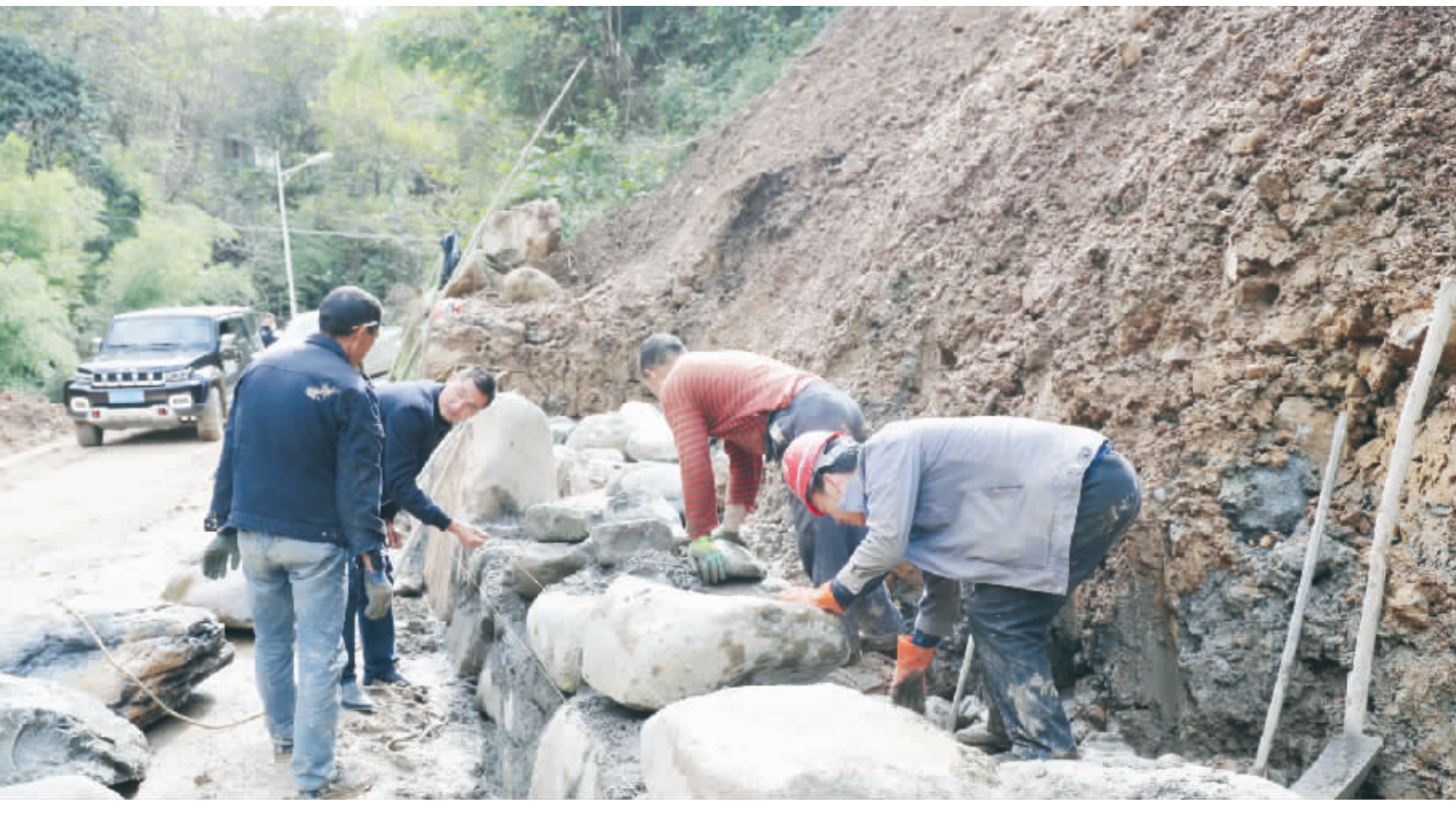
近几个月的强降雨造成岚皋县滔河镇境内20个村的道路出现不同程度塌方、水毁，该县交通局及时拨付专项资金20余万元用于灾后重建，各村抢抓有利时机组织人力机械修复道路，确保村民出行畅通便利。张天兵 谭静纹 摄
