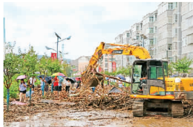
↑8月22日,石泉县发生强降雨,致使池河水暴涨,大量漂浮物涌上河堤路,严重影响道路通行和生产生活秩序。图为池河镇政府出动大型机械清理漂浮物和淤泥。 张磊 摄
