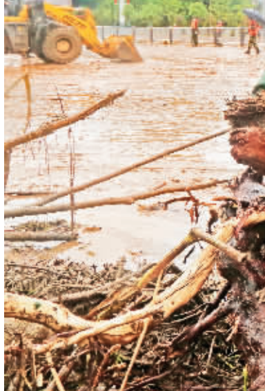
8月22日，因强降雨天气，汉阴县城区河水超最高水位，城镇街道淹没，人民群众生命财产安全受到严重威胁。灾情发生后，武警安康支队闻令而动，迅速启动应急预案，出动百余名官兵携带冲锋舟、救生衣、手锯等救援装备紧急驰援，迅速投入到封控警戒、疏散群众、清理淤泥等任务中。 赵坤 摄
