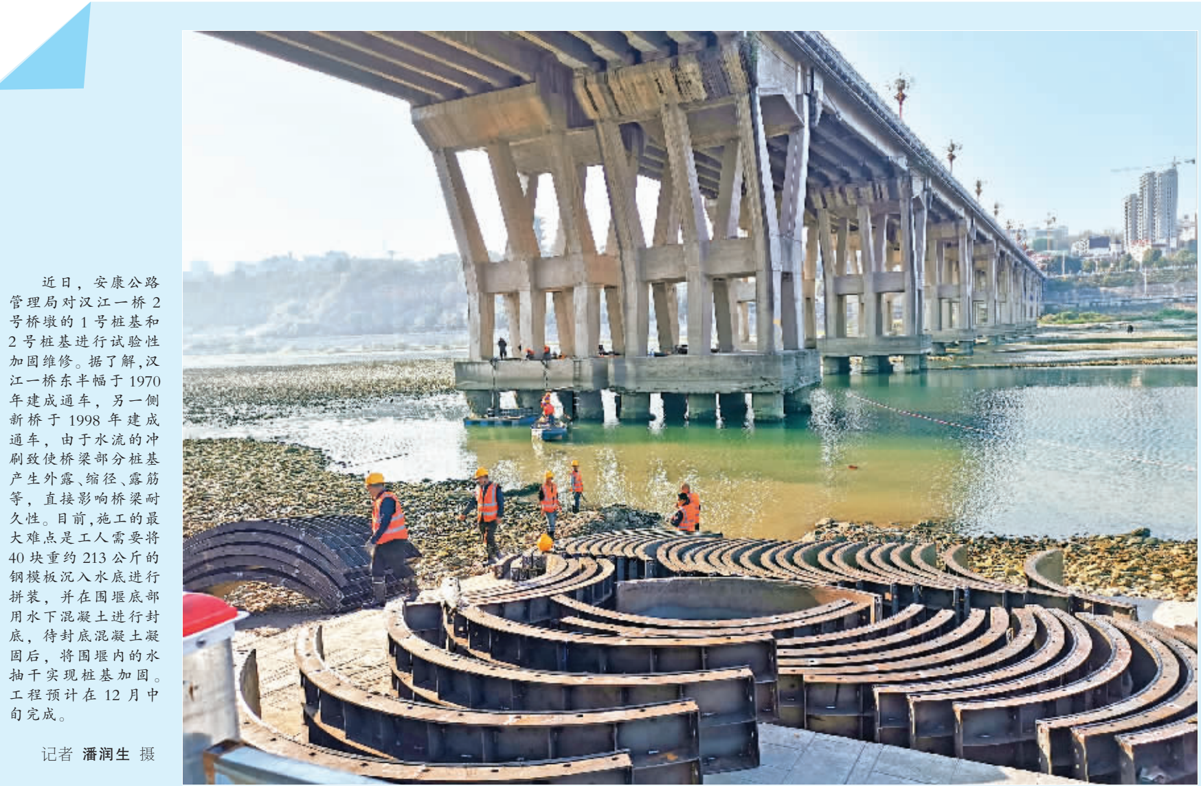
近日,安康公路管理局对汉江一桥2号桥墩的1号桩基和2号桩基进行试验性加固维修。据了解,汉江一桥东半幅于1970年建成通车,另一侧新桥于1998年建成通车,由于水流的冲刷致使桥梁部分桩基产生外露、缩径、露筋等,直接影响桥梁耐久性。目前,施工的最大难点是工人需要将40块重约213公斤的钢板沉入水底进行拼装,并在围堰底部用水下混凝土进行封底,待封底混凝土凝固后,将围堰内的水抽干实现桩基加固。工程预计在12月中旬完成。
