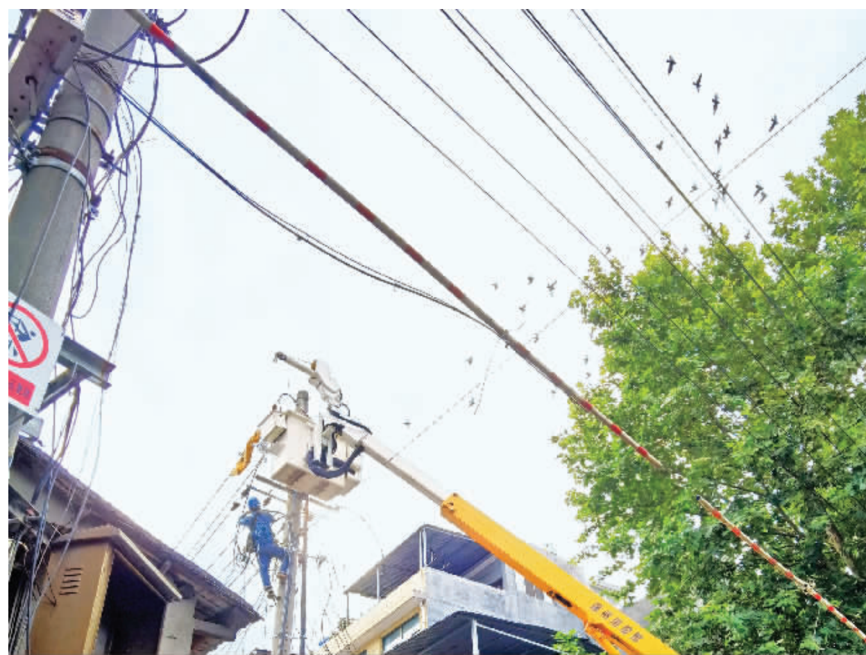
为提升安康老城区功能,保障群众夏季用电安全,近日,市供电局的工程人员在鼓楼街对老旧线路进行升级改造。吴定国 摄
