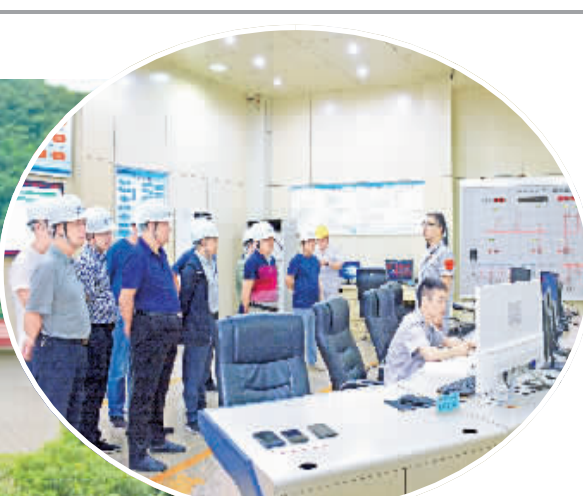
6月12日,岚皋县城关镇针对辖区进入主汛期的实际,未雨绸缪,及早安排部署防汛抗洪工作。组织防汛指挥部成员单位和城区四大责任片区、防汛临时安置点、各社区负责人及相关工作人员召开汛情、责任、措施交办会,进一步熟悉《防汛防滑工作预案》,签订《防汛责任书》,并实地到岚河水电开发有限公司厂房、简河口水电站等重点防汛部位现场踏看,以此落实值班制度,加强监测预警,严阵以待,不断提高防灾减灾意识和能力。唐定莹 摄
