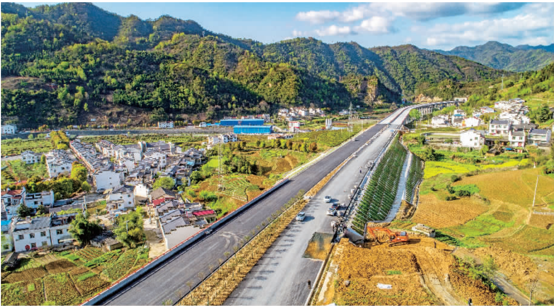
3月31日,在平镇高速1标段平利县龙头村施工现场,挖掘机轰鸣,运输车穿梭,施工现场一派繁忙景象。据悉,平镇高速公路预计今年国庆节前夕建成通车。
