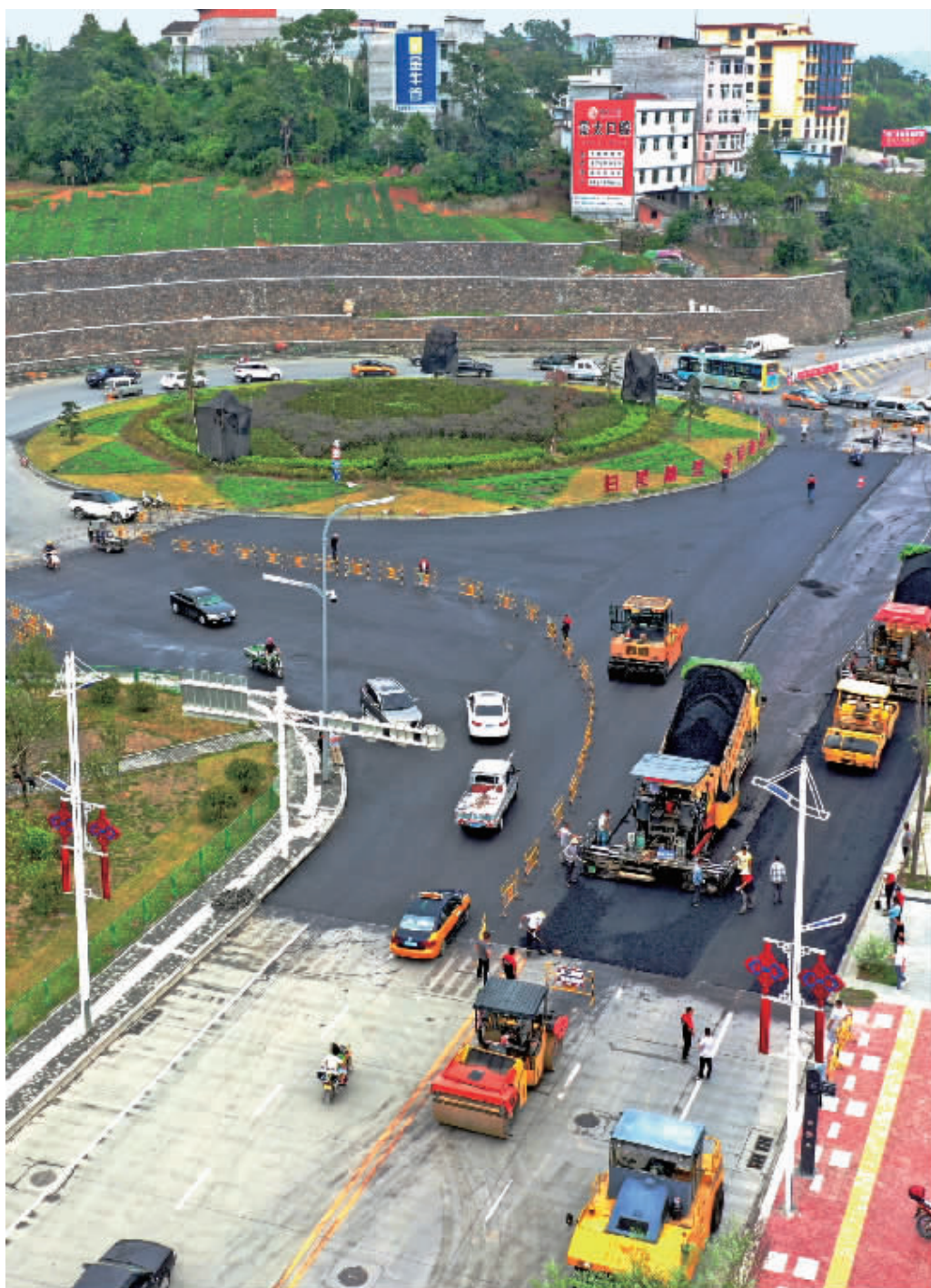
9月8日，工程人员开始对东坝汉江大桥北头交通岛区域进行道路上面层铺设。据工程指挥部工作人员介绍，此次道路铺设面积约1.4万平方米。为保障工程质量，此次施工均在白天进行，因该路段交通压力较大，需一边施工一边保畅，预计工期为3天。
